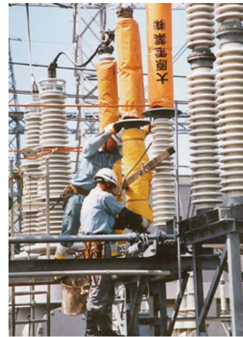
1999年(平成11年)発電現場
